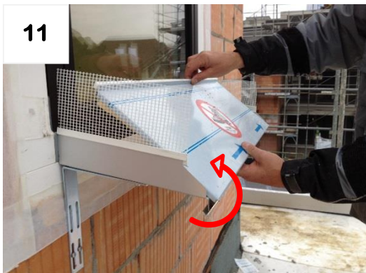
Fensterbank über Tropfnase einhängen
