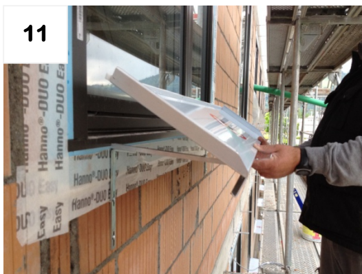
Fensterbank über Tropfnase einhängen
